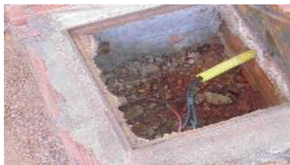
Foto 52 - Detalhe da caixa de passagem (elétrica), que deve receber uma camada de brita no fundo, evitando o contato direto entre condutores e umidade do solo
